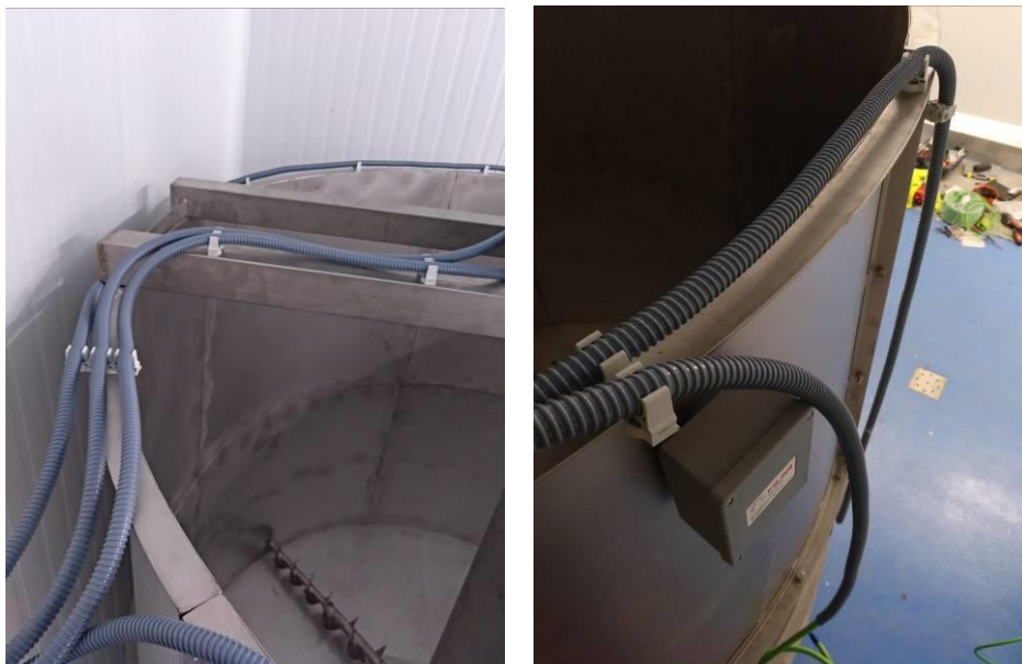
Cableado por parte superior silo
